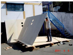
4. 両側面部材を反転し裾用30mm角材を追加 *真ん中のパネルの孔は窓
